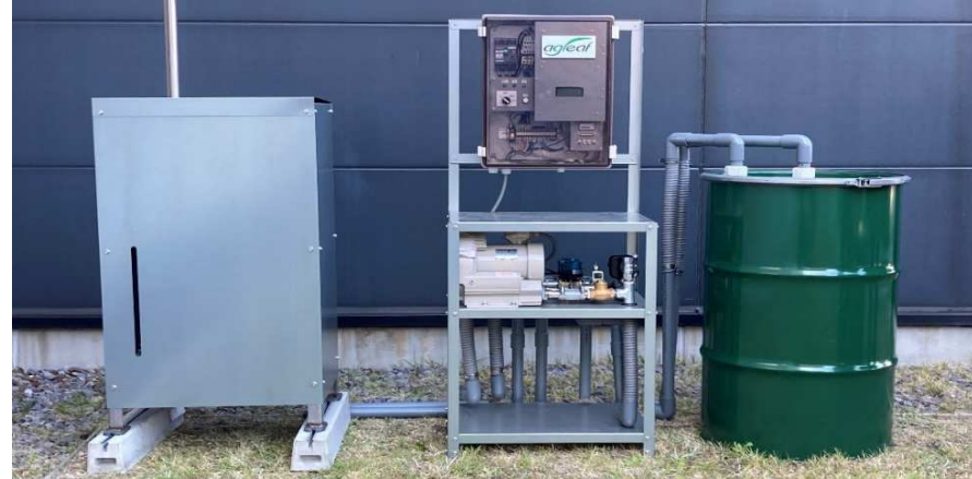
室外ユニット 貯留ユニット
